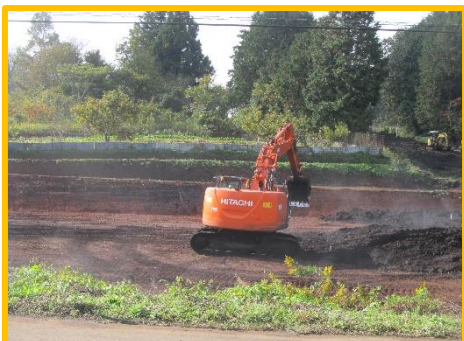
今年に限り、ほ場整備工事で6~10番は全面通行止めになっています
